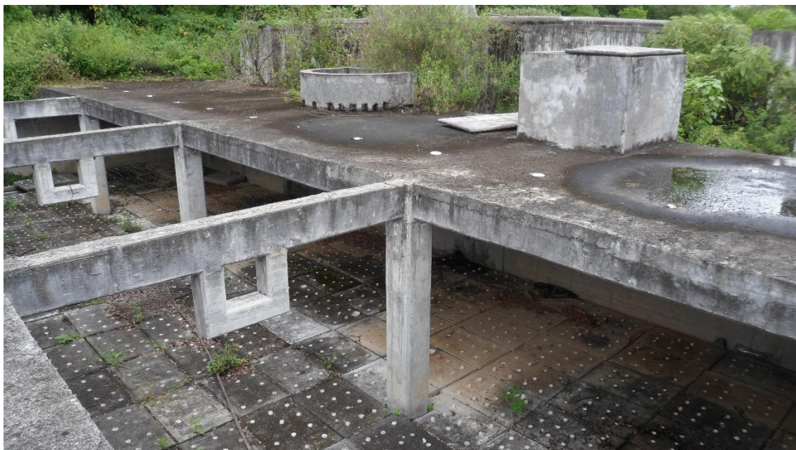
Planta tratadora de aguas residuales inhabilitada.
